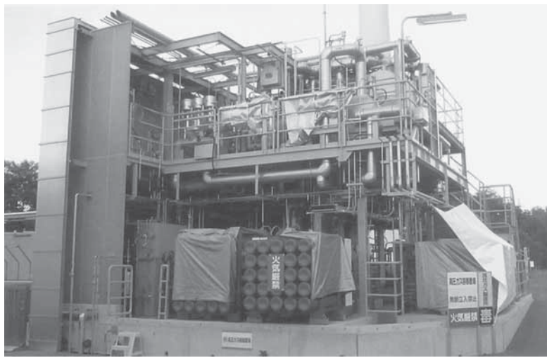
Опитната инсталация в Института за възобновяема енергия във Фукушима, Япония използва слънчева енергия, за да произвежда до 50 кг амоняк на ден
